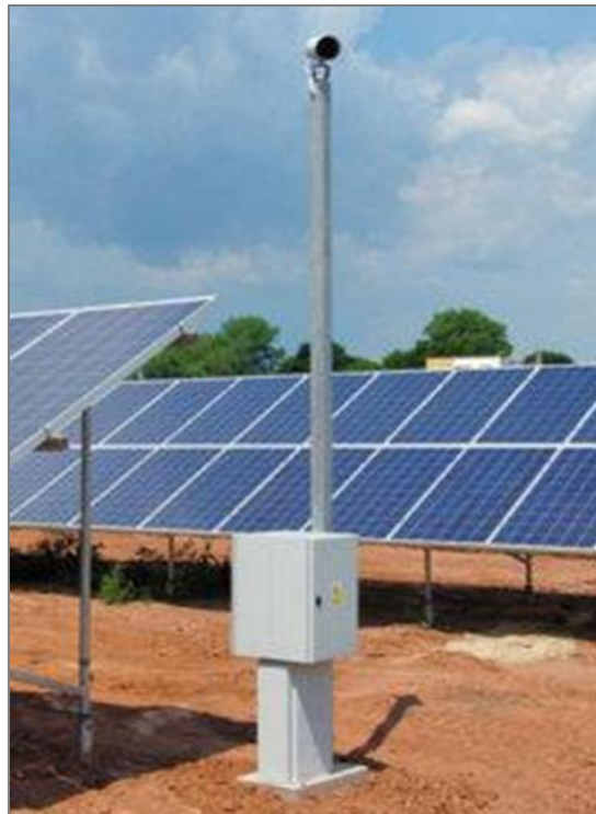
Figura 3-37 Ejemplo de cámara de vigilancia
