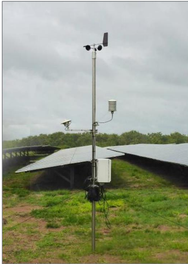
Figura 3-10 Ejemplo de una estación meteorológica en una planta solar
