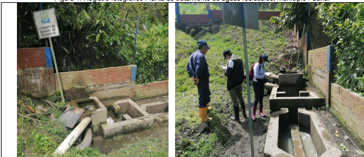
Figura 4. Registro fotográfico Planta de tratamiento de aguas residuales, municipio Pauna.
