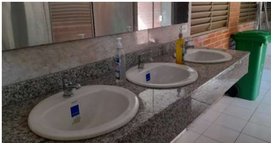
Lavamanos con llaves convencionales baño mixto instalaciones exteriores
