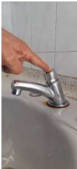
Válvula ahorradora averiada baño caballeros primer piso
