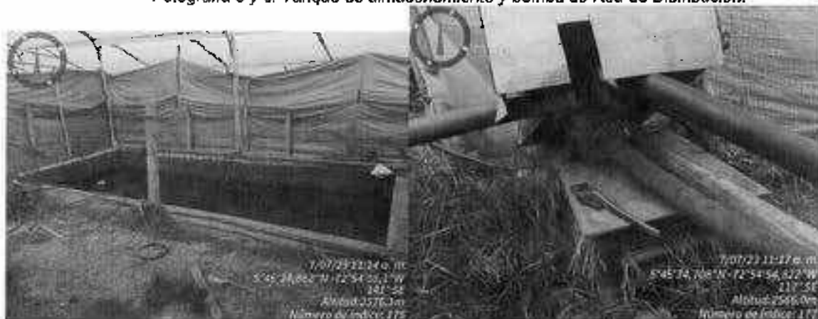
Fotografía 5 y 6. Tanque de almacenamiento y bomba de Red de Distribución.
