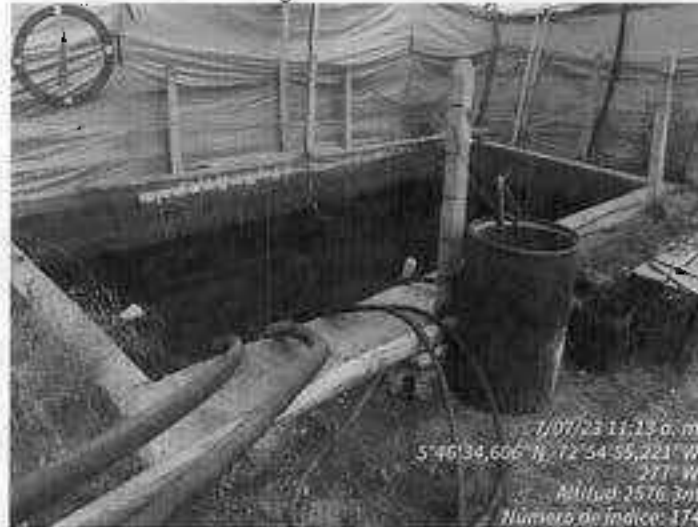
Fotografía 4. Red de Distribución
