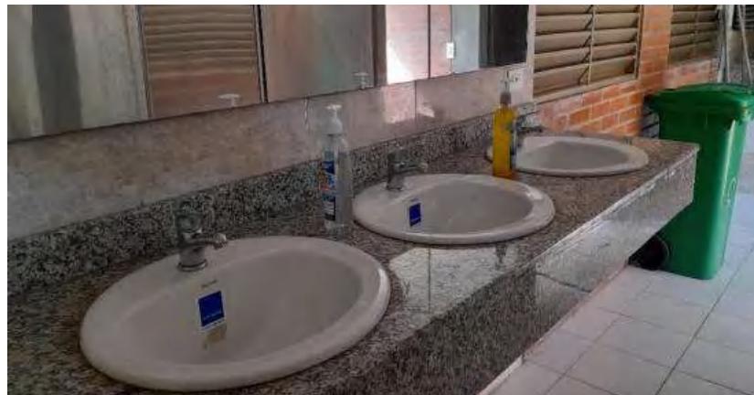
Lavamanos con llaves convencionales
