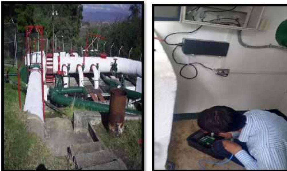
Foto 43. Instalación sensorica Túnel de Cuítiva
