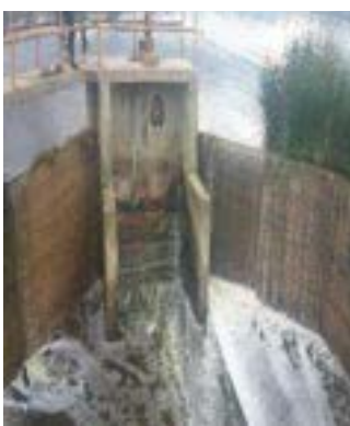
Estado compuerta anterior
