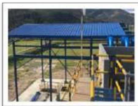
Pasarela y barras desarenador.
