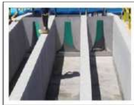
Sistema de medición de caudales
