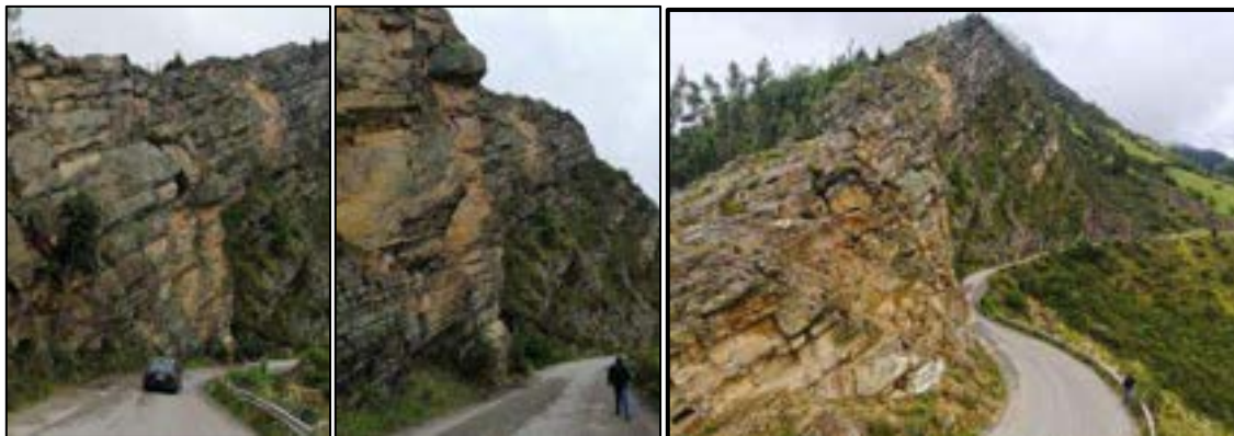
Figura 93. Imágenes de fracturamiento macizo rocoso, sector “La Peña”, vía Mongua-Tópaga
