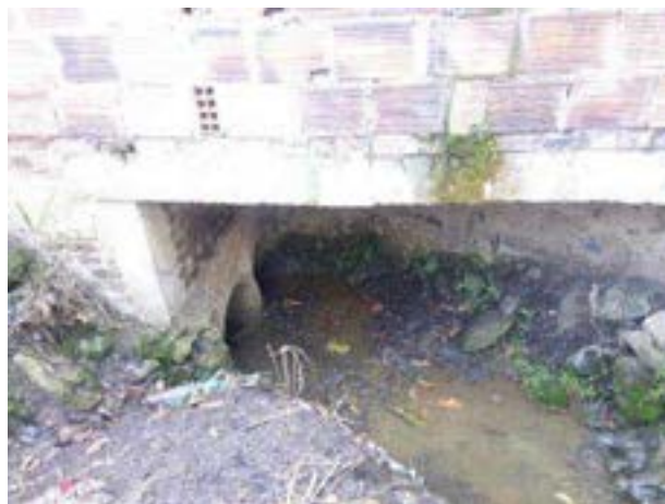
Imagen 32 Imágenes recorrido diagnóstico Quebrada “La Fiscalía” – San José de Pare
