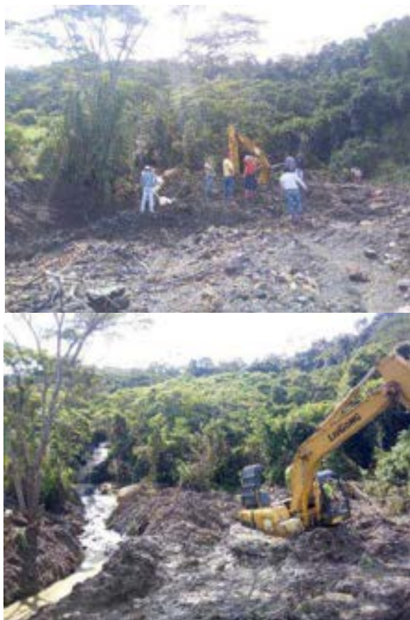
Figura 21. Vista del área de cultivo afectada por el desbordamiento del cauce de la quebrada El Barro.
