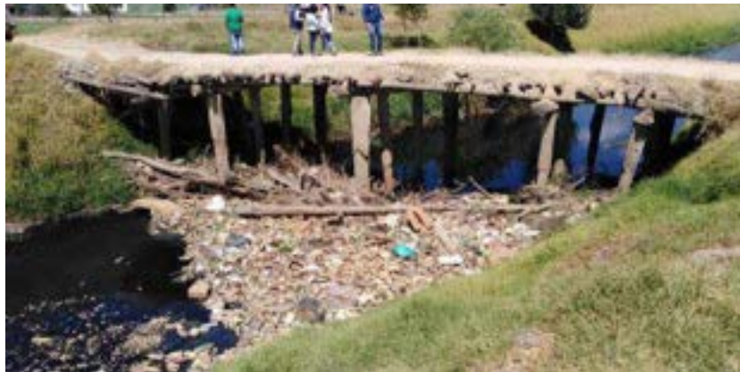
Figura 105 Imagen sitio crítico Canal "Venecia" – Sogamoso
