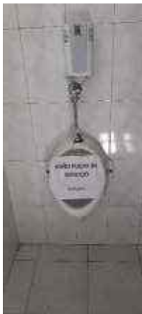
Orinal fuera de servicio baño caballeros primer piso
