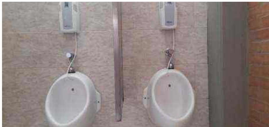
Orinales con válvulas ahorradoras baño mixto instalaciones exteriores
