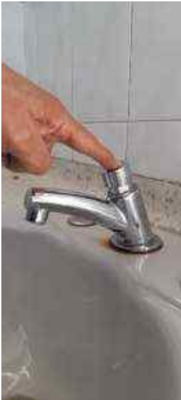
Válvula ahorradora averiada baño caballeros primer piso
