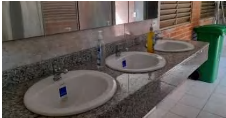
Figura 6 LAVAMANOS CON LLAVES CONVENCIONALES
